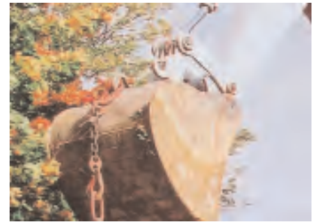
Abb. 12: Führung des Anschlagmittels über eine Schaufelrückwand
